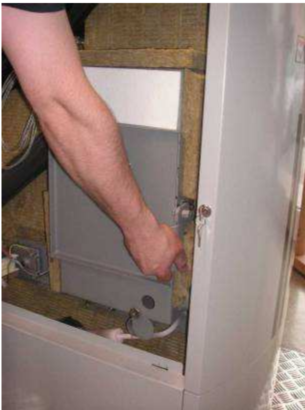
Öffnen der Brennkammertür
