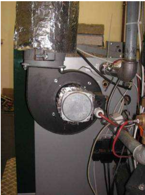
Ansicht von hinten auf Ventilator
