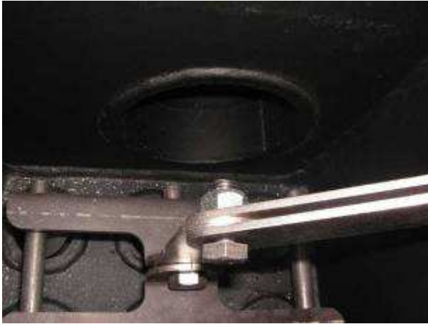
Ansicht auf Wärmetauscherreinigung
