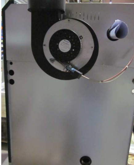
Vue sur l'arrière du ventilateur d'extraction
