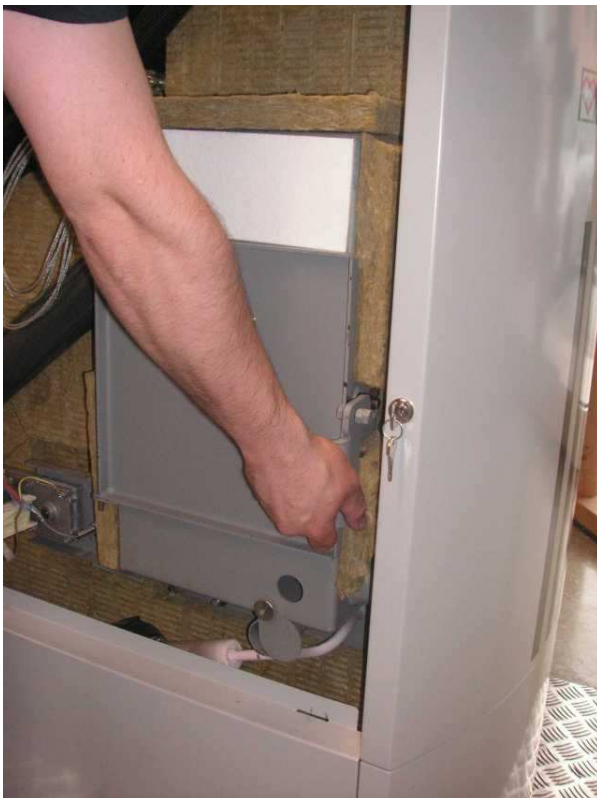
Ouverture de la porte de la cellule de combustion
