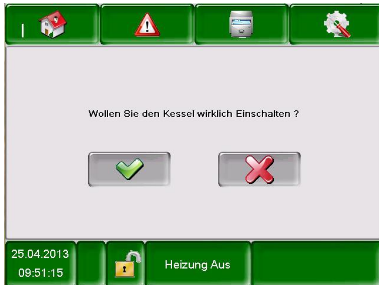
Bild 7.1: Einschalten der Anlage bei eingegebenem Code
