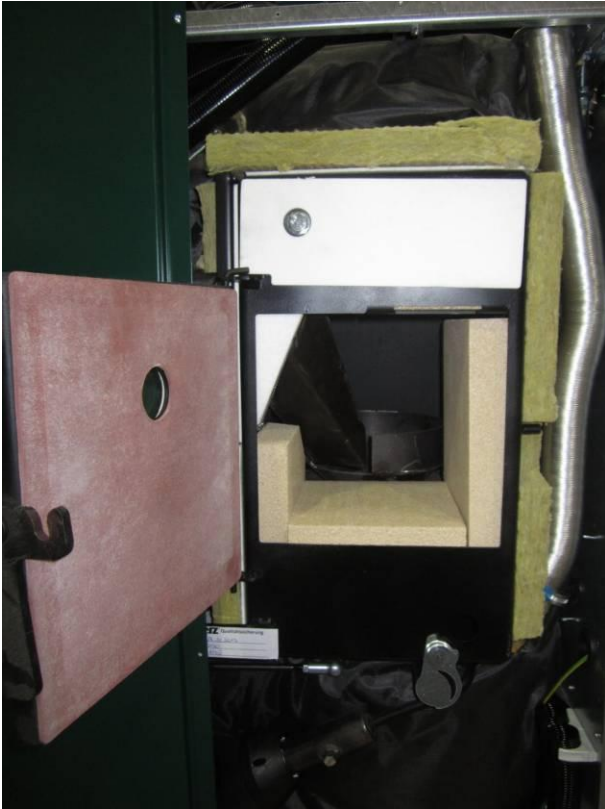
Herausnehmen der Brennraumisolierung
