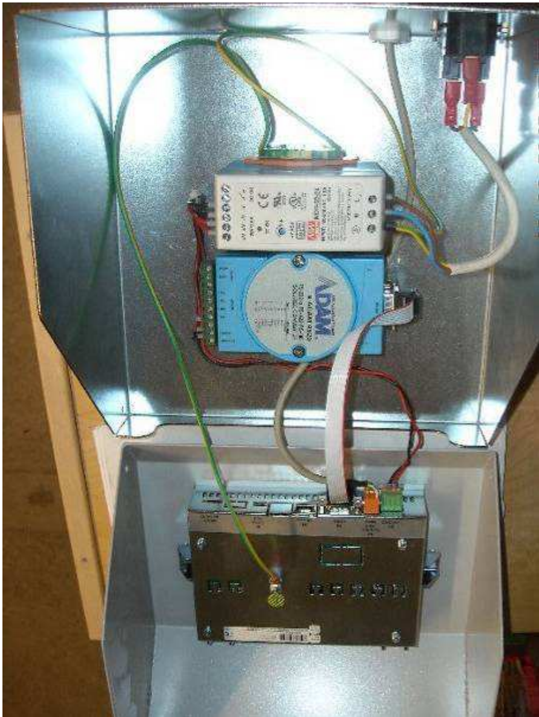
Abbildung der ModControl Vorverkabelung
