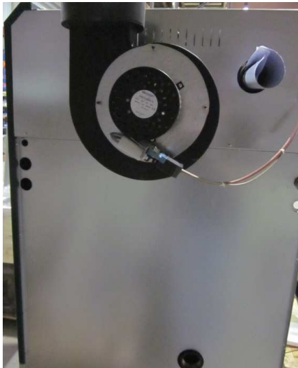
Vue sur l'arrière du ventilateur d'extraction
