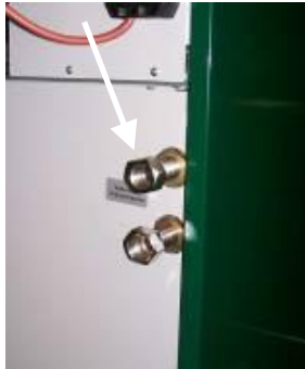
Raccordement eau froide
