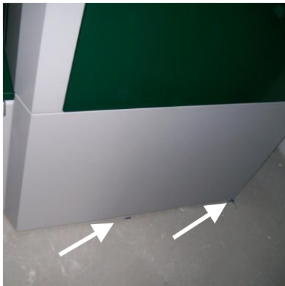
Positionnement de la chaudière selon les plans! (Traces au sol) Les mesures se réfèrent à l'habillage.
