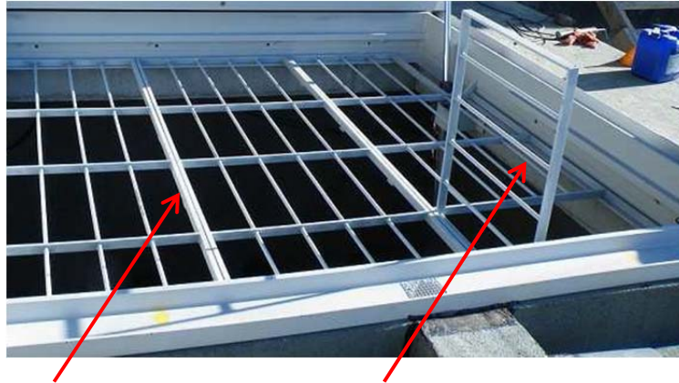
Grille de sécurité avec trappe de passage homme ouverte (pour accès au silo)
